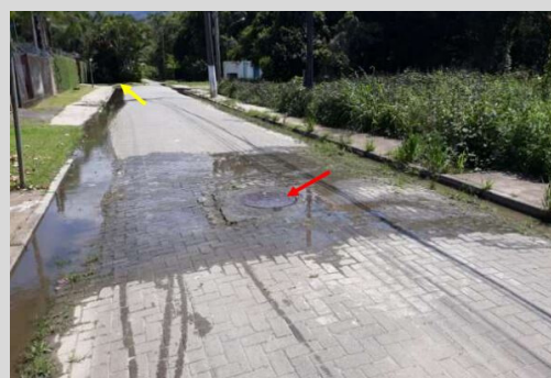
Figura 4: esgoto extravasando pelo bueiro (seta em vermelho) e escoando a céu aberto sendo escoado (seta em amarelo) diretamente para o Rio Negro.
